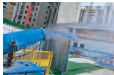
工地出入口雾炮机
